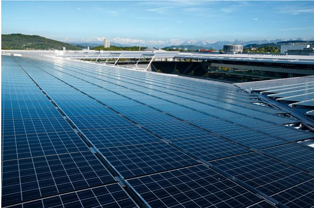
Photovoltaik-Anlage auf dem Dach des „Stade de Suisse“ Wankdorf Bern (© TRITEC AG Schweiz, Aarberg)
